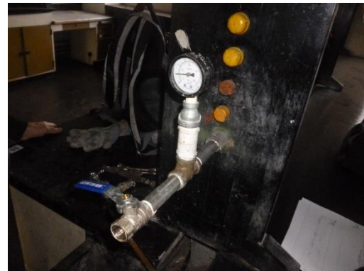
Imagen 12. Toma de presión en laboratorios de tercer piso.
