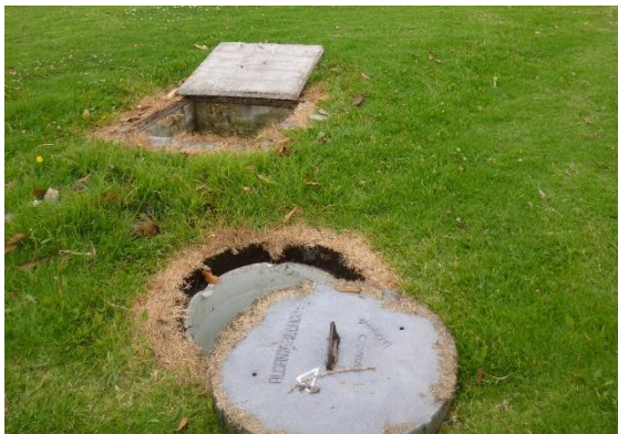
Imagen 34. Pozo de inspección y caja de toma de muestras en buen estado.
