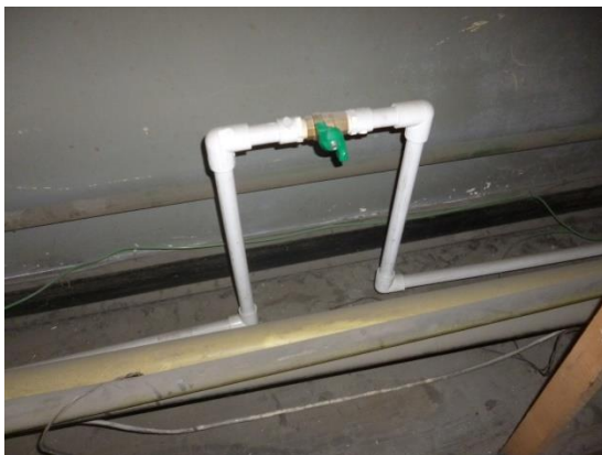
Imagen 9. Válvula de corte de redes internas en buen estado
