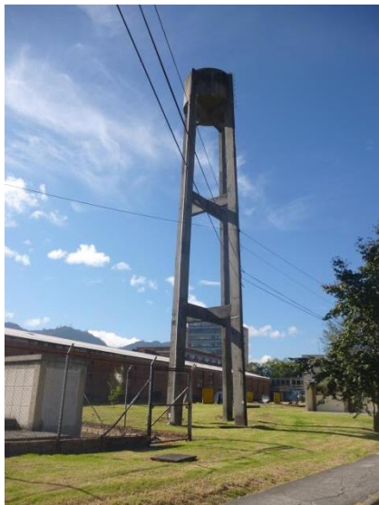
Imagen 2. Tanque almacenamiento alto
