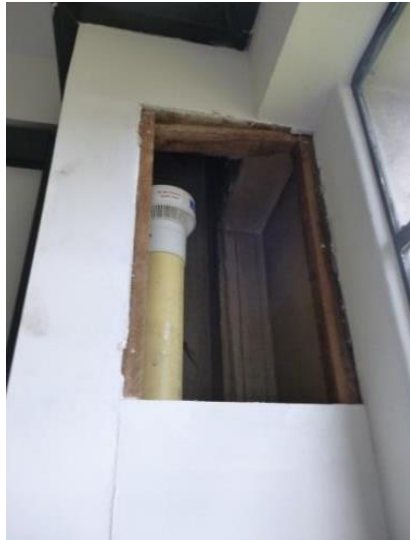
Imagen 21. Válvula de aireación en terminación de bajante de aguas residuales.
