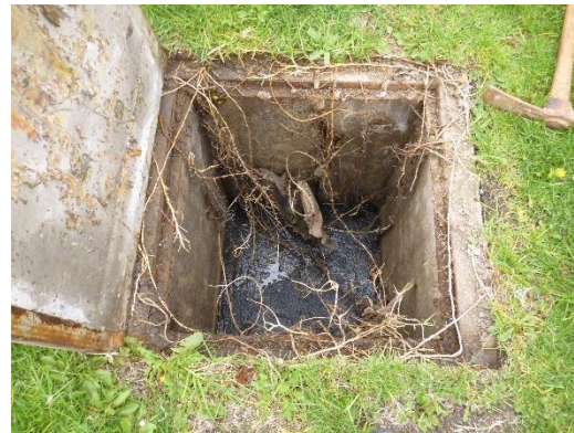
Imagen 35. Caja de inspección de aguas residuales totalmente colmatada.
