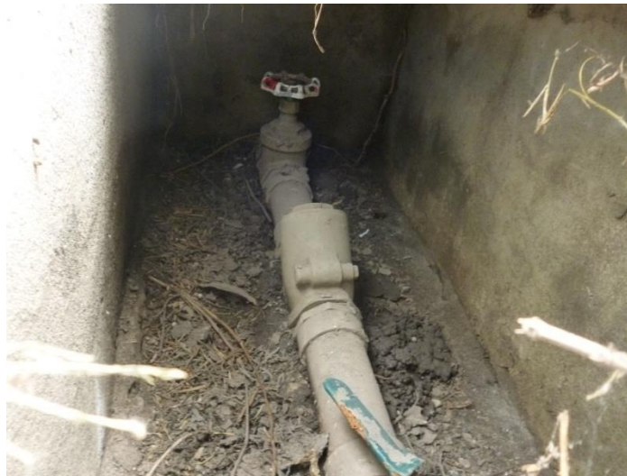
Imagen 4. Válvula de paso directo y válvula de retención en el by-pass del sistema.
