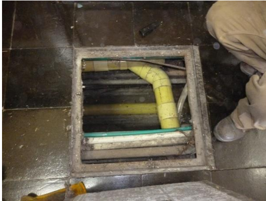
Imagen 24. Conducciones de aguas lluvias en PVC, en buen estado por
