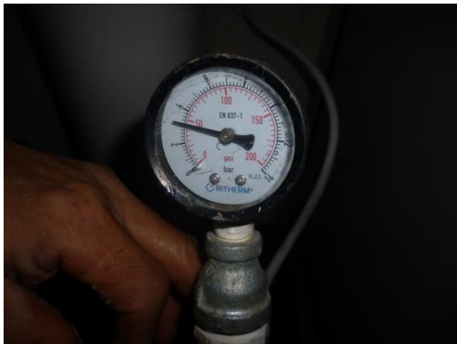
Imagen 11. Toma de presión en baño de primer piso.
