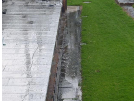
Imagen 31. Acumulación de aguas lluvias en el perímetro del edificio.
