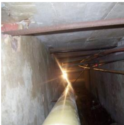
Imagen 17. Conductos por cárcamos soportados adecuadamente.
