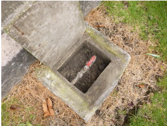
Imagen 5. Válvula de sectorización tipo bola de la red en PVC presión en buen estado
