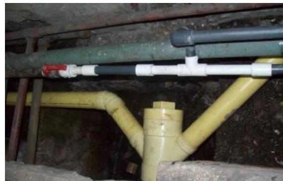
Imagen 18. Tapones de inspección en excelente estado y debidamente localizados.
