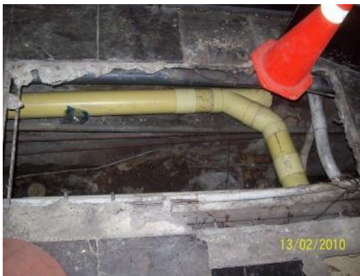
Imagen 26. Tapón de inspección y limpieza en conducciones de aguas lluvias en buen estado.
