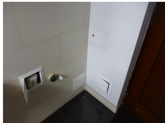
Imagen 10. Válvulas con sus respectivas cajas para manipulación, en buen estado.
