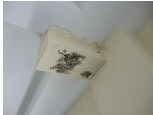
Imagen 29. Humedad en cielo raso por unión entre PVC y HF.
