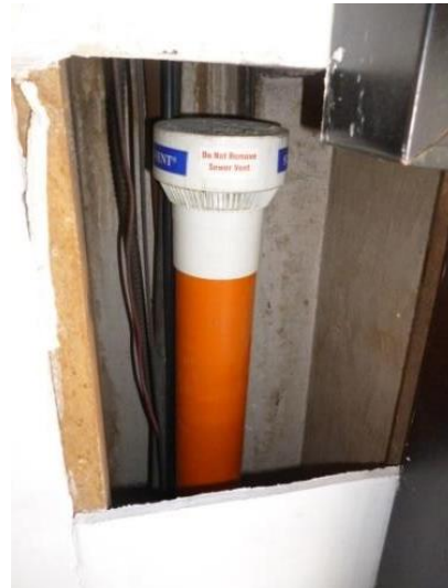
Imagen 22. Válvula de aireación en terminación de bajante de aguas residuales industriales.
