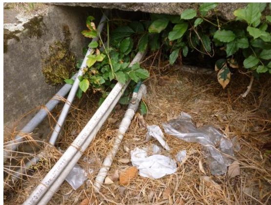
Imagen 7. Red exterior de suministro de agua potable en material PVC
